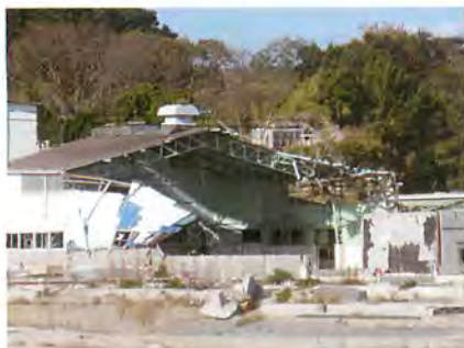
●津波にあった豊間地区 壊れた工場
